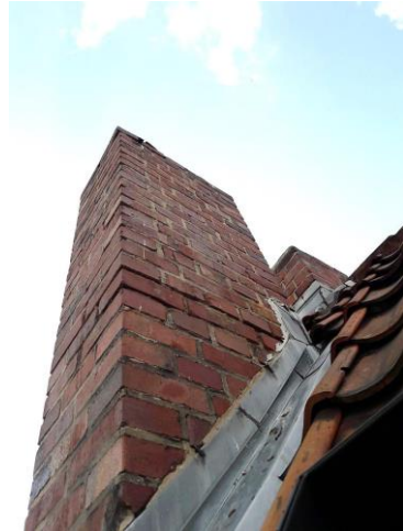
Der reparaturbedürftige Schornstein
